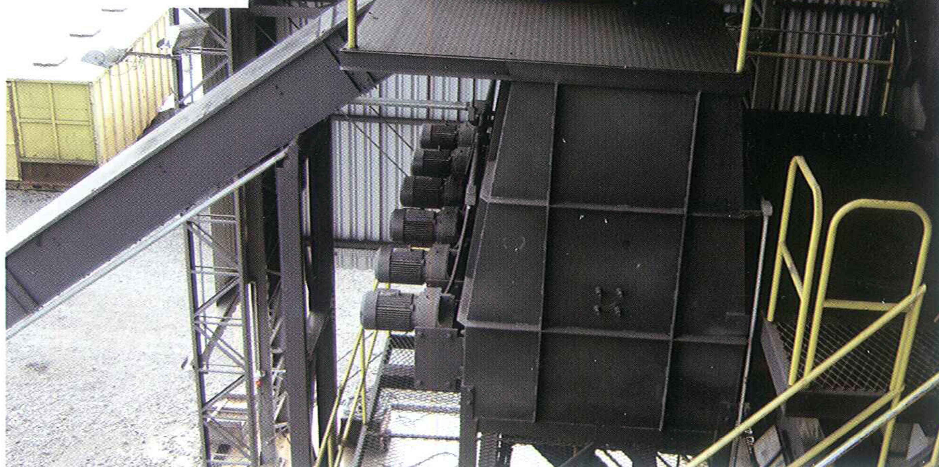
Transportador de corrente com taliscas para alimentar caldeiras com cavacos ou biomassa.
