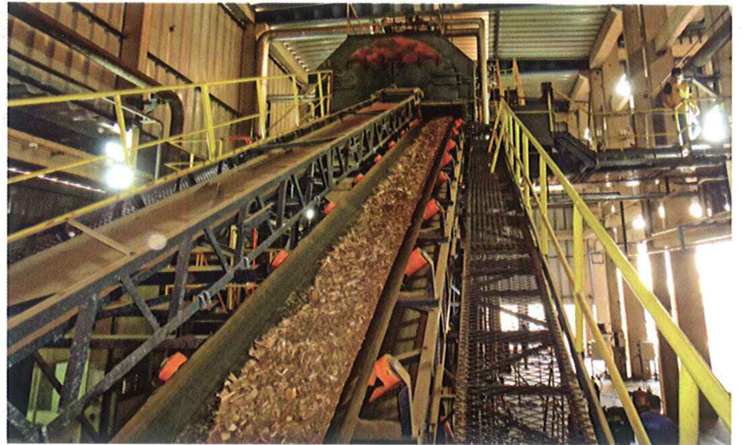
Transportador de correia para alimentação de caldeira
